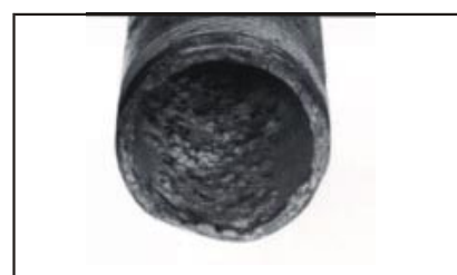
Obr. 7-3. Kyslík v systému urychluje korozi, způsobuje pitting, jak je ukázáno zde.
